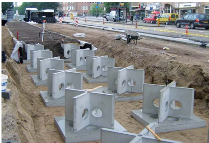
En trægrube af 'Treebox'. Låget er også af beton. Foto: CROW.
